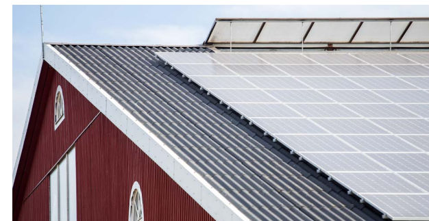
Solpaneler som monterats felaktigt kan bli en försäkringsfälla.
