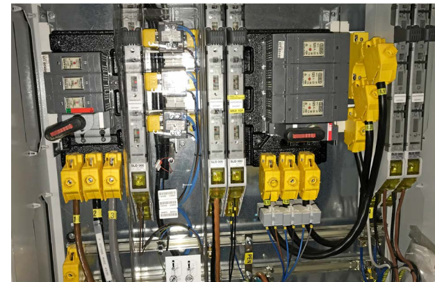
Hjärtat i anläggningen. Hit kommer strömmen från både den gamla anläggningen och från den nya. Överskottet går vidare ut på nätet.
